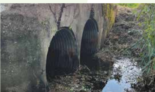
Buses métalliques Grezac / Meursac
